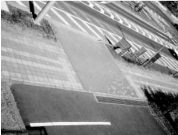
4途中で切断されている点字ブロックの例
